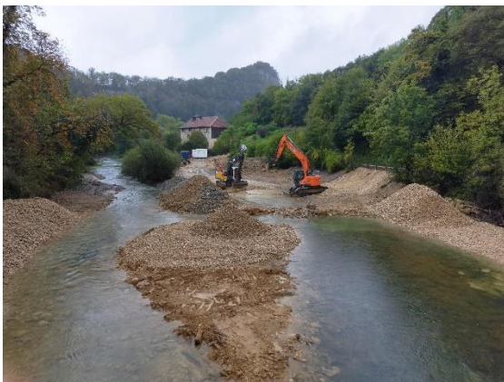
Chantier le 26 septembre, création îlot central et des banquettes sur les berges
