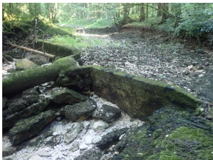
Seuil et canalisation en mauvais état
