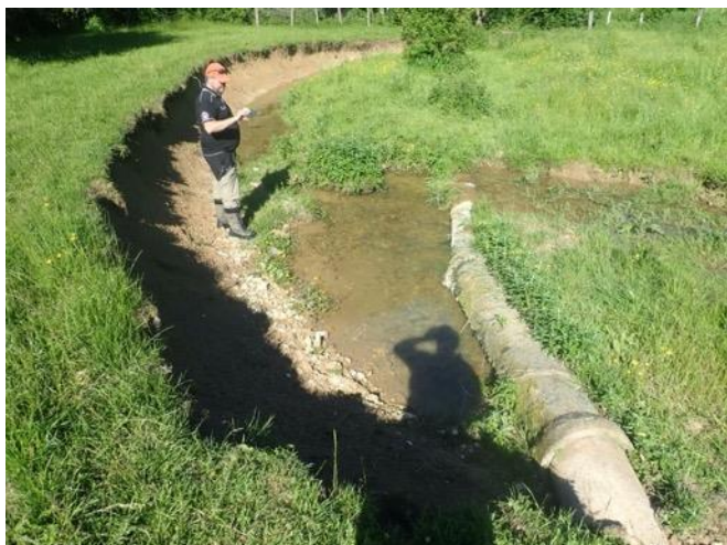
Erosion dommageable en amont de Martinvaux
