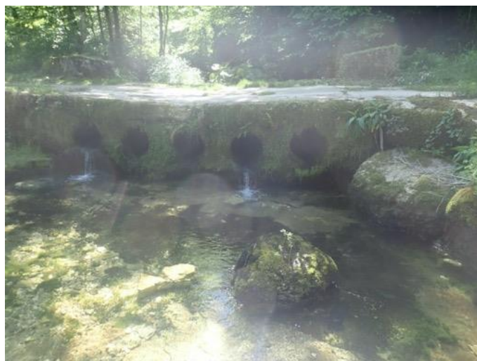
Passage busé problématique sur le ruisseau de Plainmont
