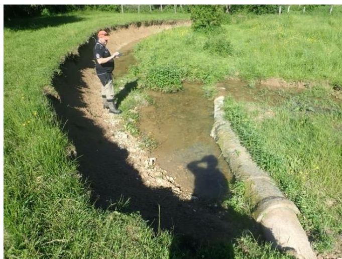
Erosion de berge en amont du puits de la Doye
