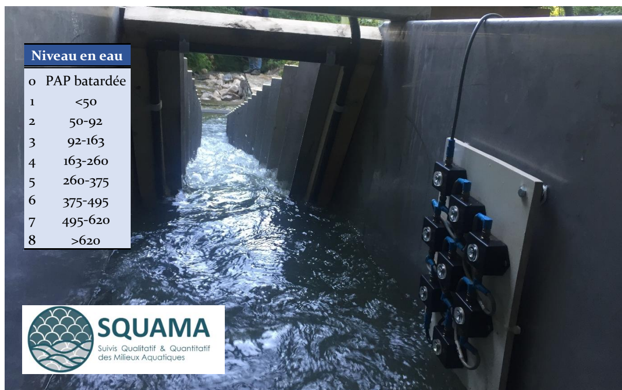
Figure 16 : Sondes SQUAMA installées dans le bassin de repos. La passe est ici batardée. Les équivalents débits sont indiqués dans le tableau, en l/s.
