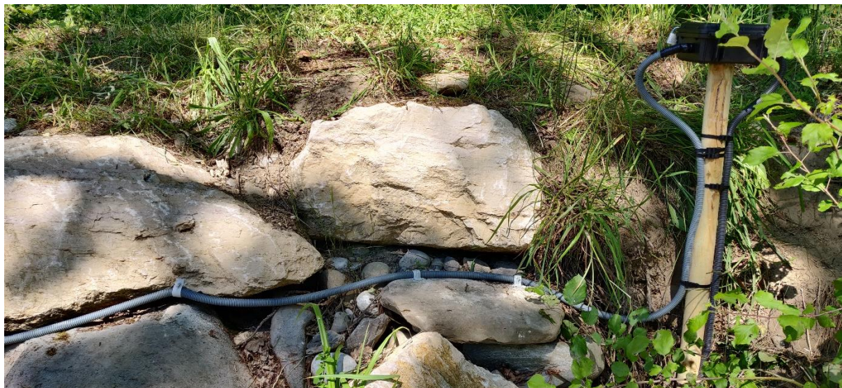
Figure 11 : Exemple d'un branchement de câble twinax sur un site d'étude.
