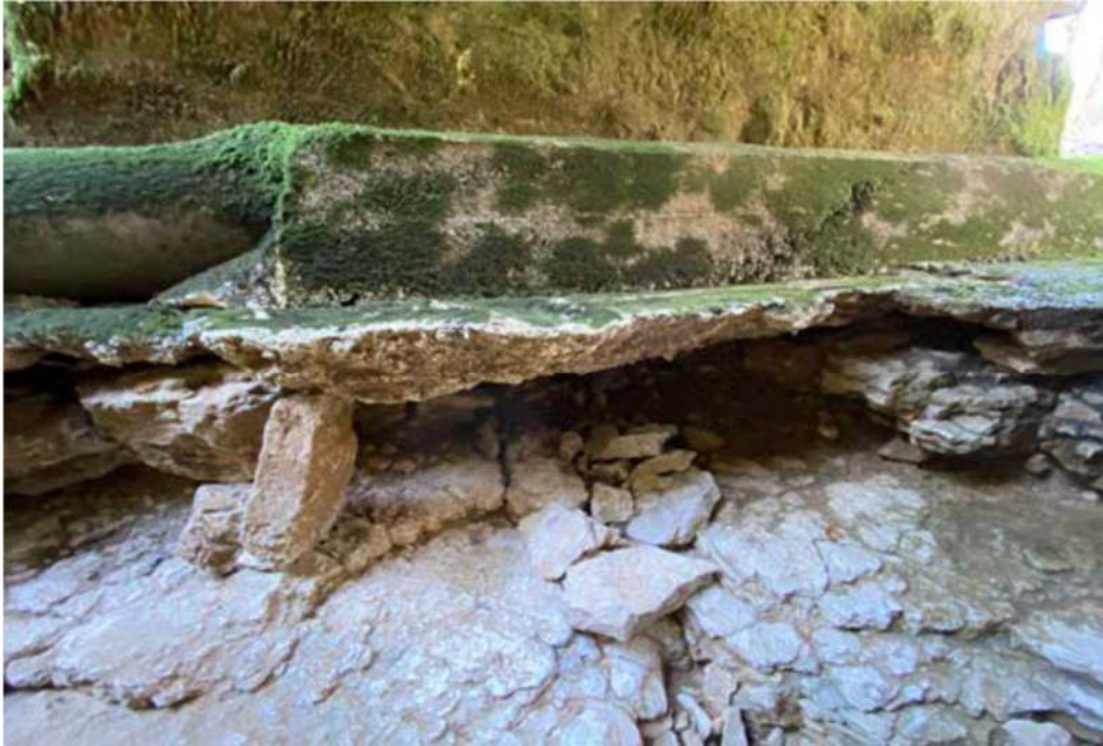
Figure 59. Affouillement des fondations du pont de Martinvaux (source : CE3E)
